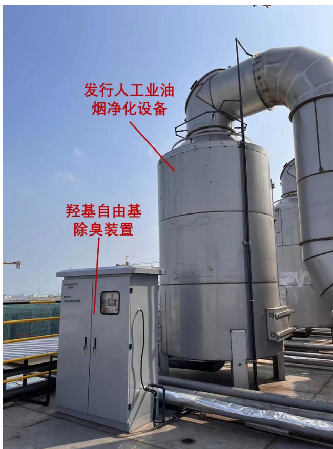
羟基自由基除臭装置安装实景图
