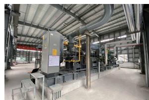
10万吨合成氨尾气综合利用 项目螺杆二氧化碳压缩机
