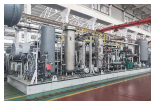
CO 2 捕集、驱油与埋存技术 示范工程配套装置
