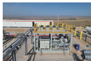
CO 2 驱综合试验站 增压液化装置
