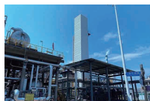
低温甲醇洗排放尾气回收年产 8万吨CO 2 项目增压液化装置
