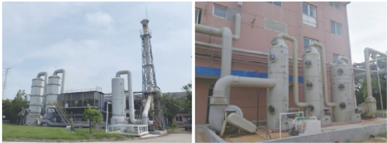
废气处理设施
