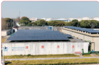
常熟基地光伏发电
