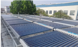
锅炉进水预热太阳能系统改造工程
