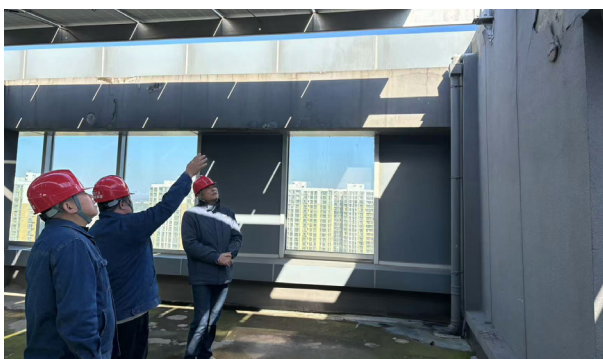
创智天地光伏桥架紧急排查
