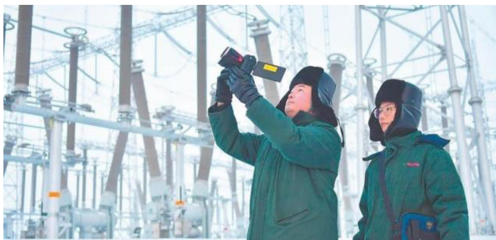
新疆皖能英格玛电厂工作人员在巡检升压站
