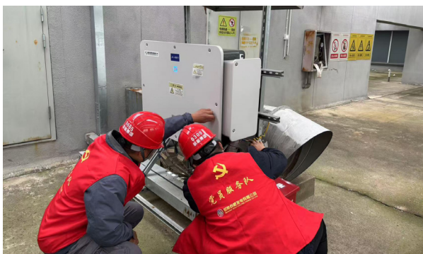
逆变器设备安全隐患排查
