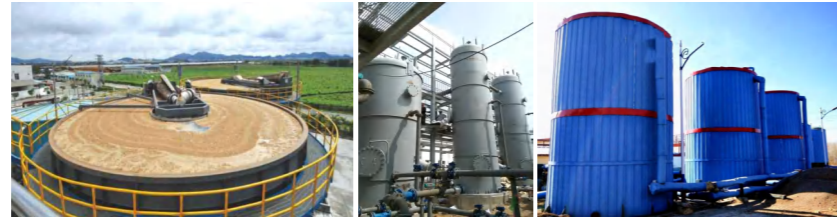
气浮机 臭氧氧化塔 曝气生物滤池 (BAF)
