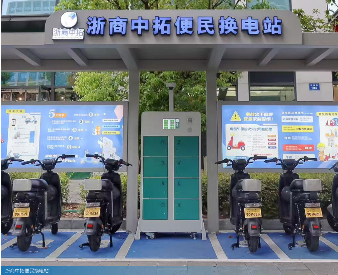
浙商中拓便民换电站
