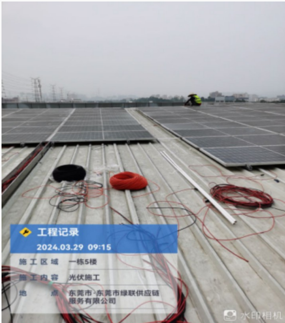
公司光伏发电设备
