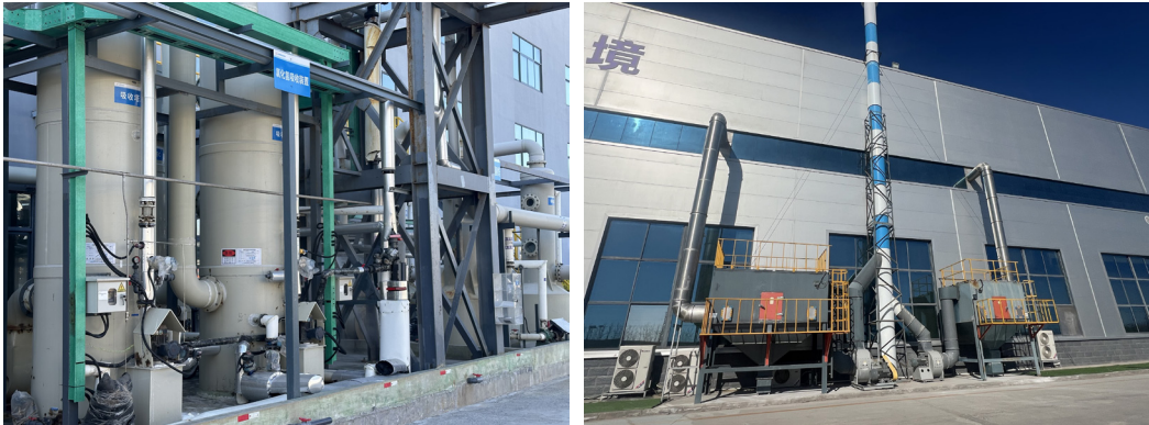
废气处理设施
