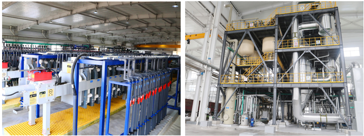
废水处理设施
