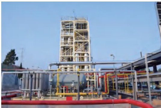
撬装天然气液化（LNG）项目
