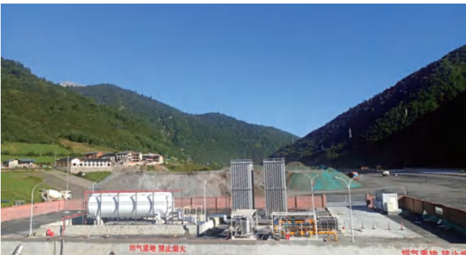
九绵高速 LM2 标段热拌站配套 LNG 气化站
