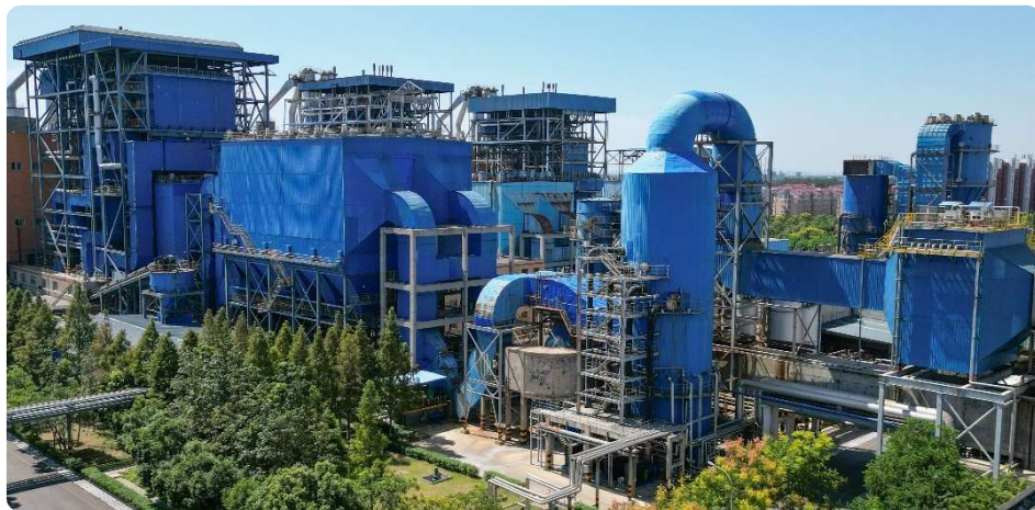
图为公司燃煤锅炉及碱回收锅炉超低排放设施
