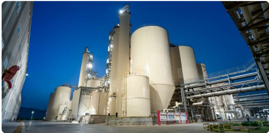
图为公司溶解浆生产线
