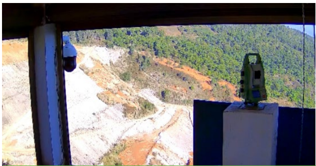
地质灾害在线监测系统测量机器人
