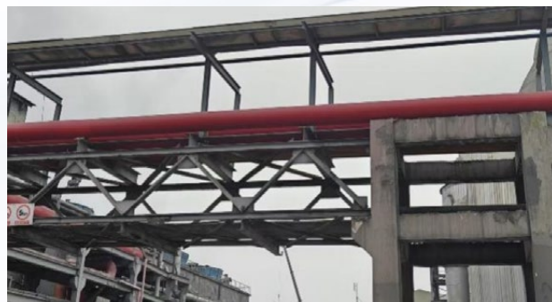
蒸汽管网保温降低热损失项目
