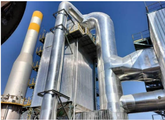
内蒙宜化石灰回转窑SCR脱硝改造项目
