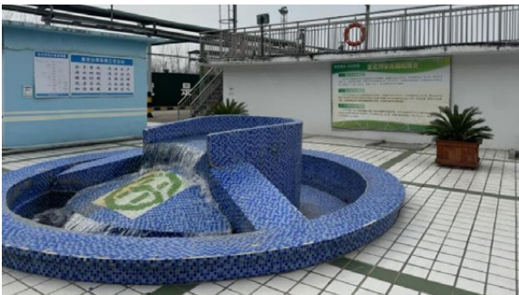
湖北宜化污水处理设施
