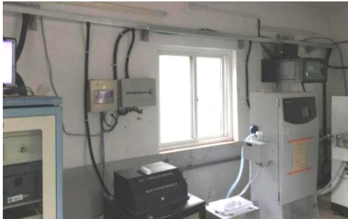
废水在线监控
