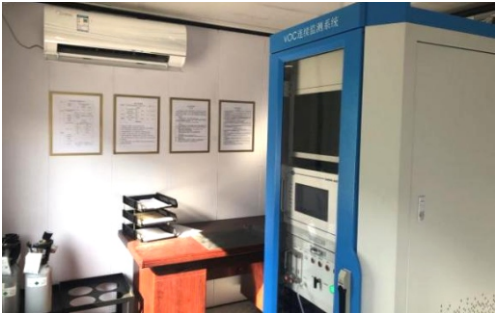
废气在线监控
