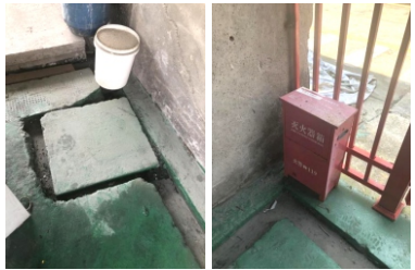
一般工业固废仓库浸出液收集池、 应急防护设施及导流渠
