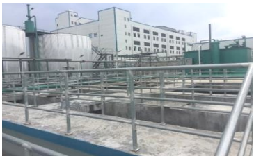
聚酯厂区污水处理站
