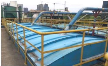
马桥化纤厂区污水处理站
