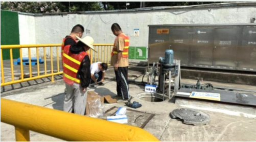
雨水排放口安装水质监控设施图
