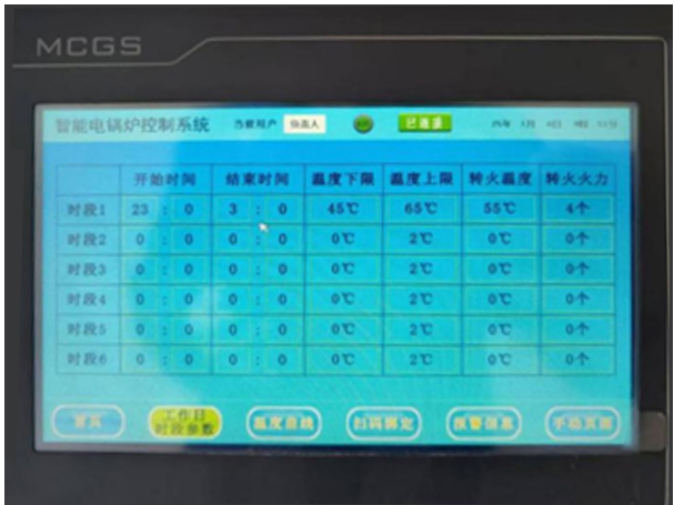
哈尔滨公司电锅炉监控面板
