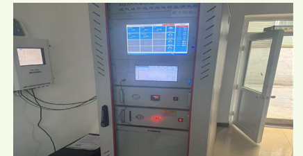
成都航天模塑有限责任公司涿州分公司 废气在线监测设备
