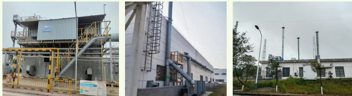
航天智造保定分 RTO 废气处理
