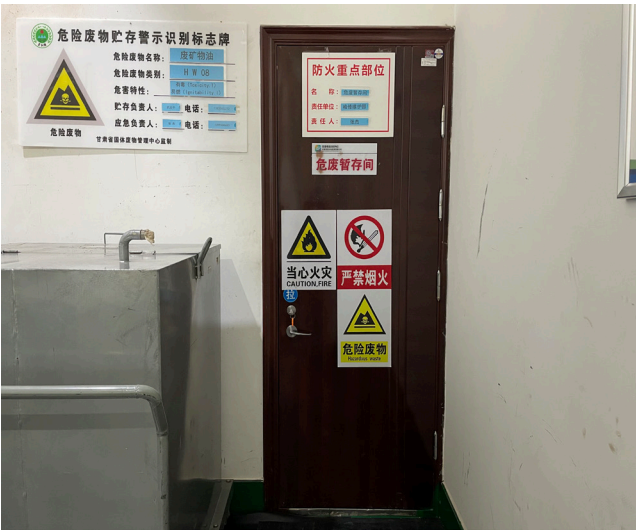
图 危废暂存间
