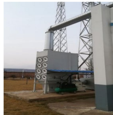
测试车间废气处理装置
