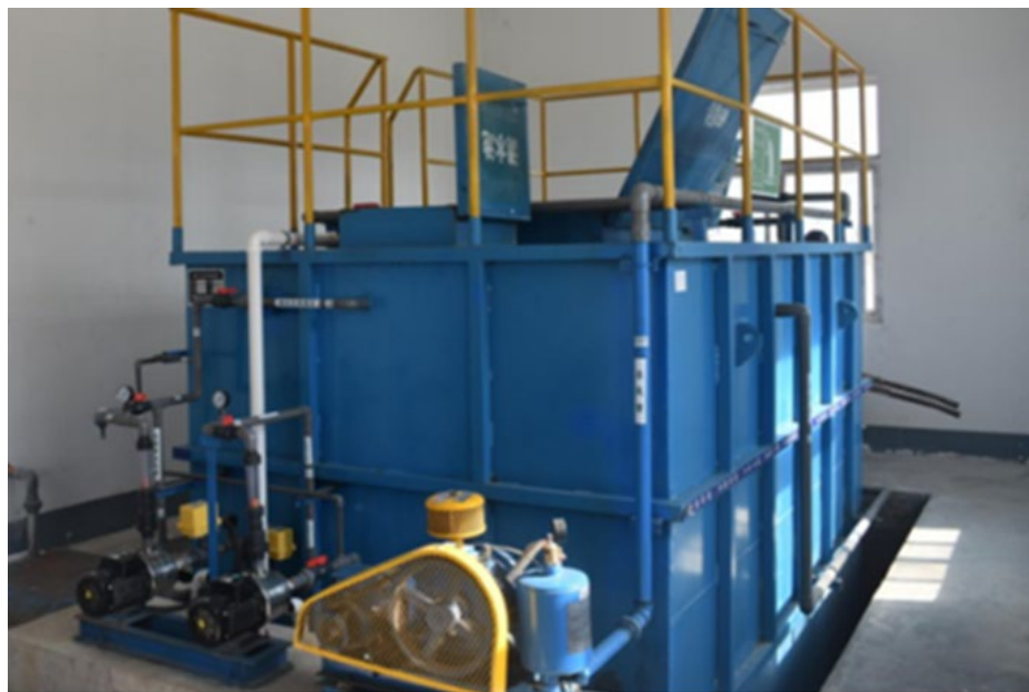
污水处理设备操作间
