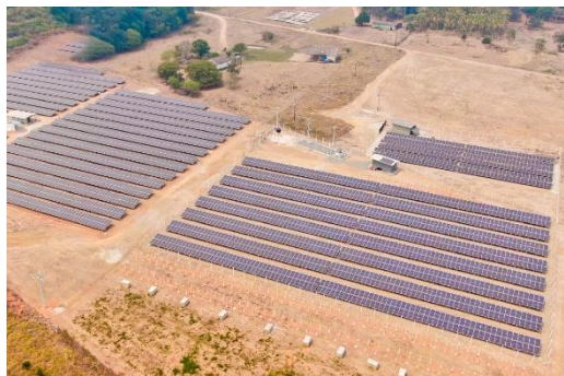
巴西 1.3MW 项目
