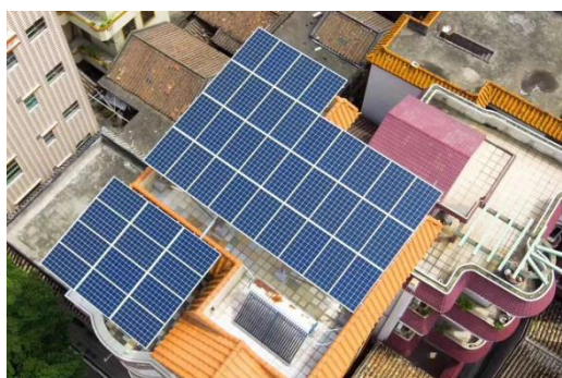
广东 12kW 项目
