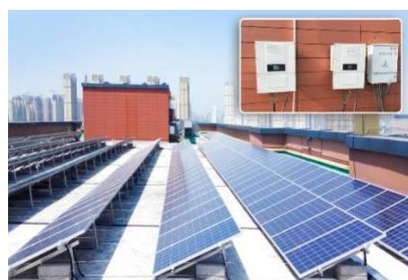
江苏 1.1MW 项目
