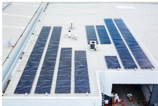
澳大利亚 30kW 项目
