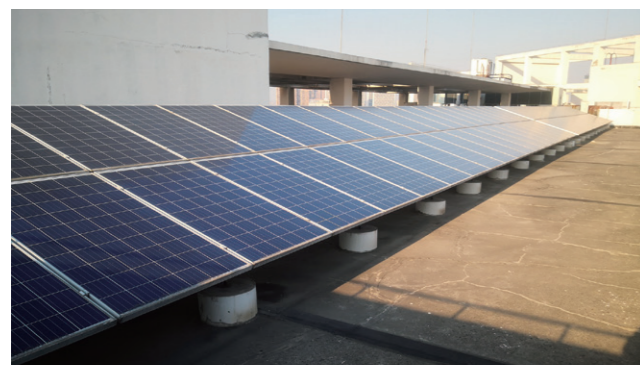
公司办公楼顶层铺设的太阳能光伏板
