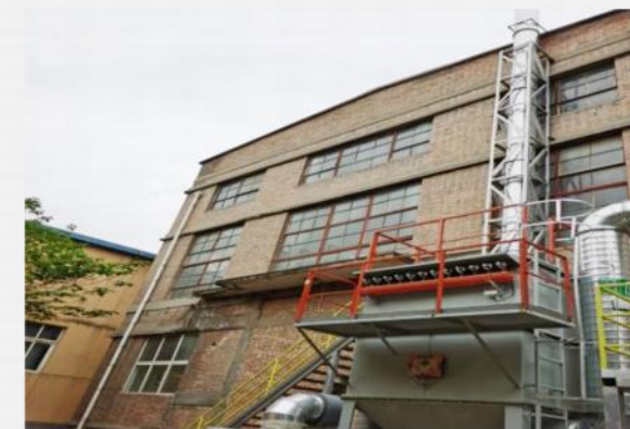
▲ 中国航发西控科技砂轮机废气治理设施更新
