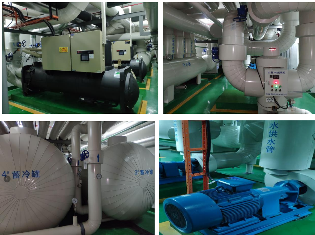
数据处理中心机房高效节能系统
