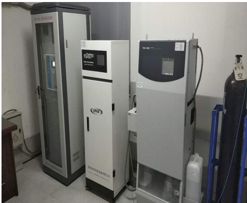
污水总排口在线监控设施
