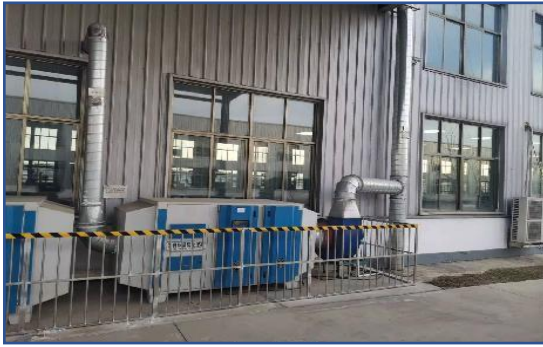
左：使用密闭管道运输废气，防止未经处理废气泄露
