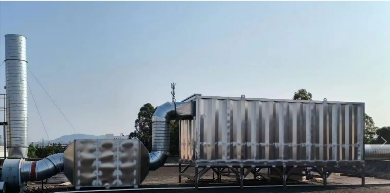
生物滤池和活性炭吸附箱装置
