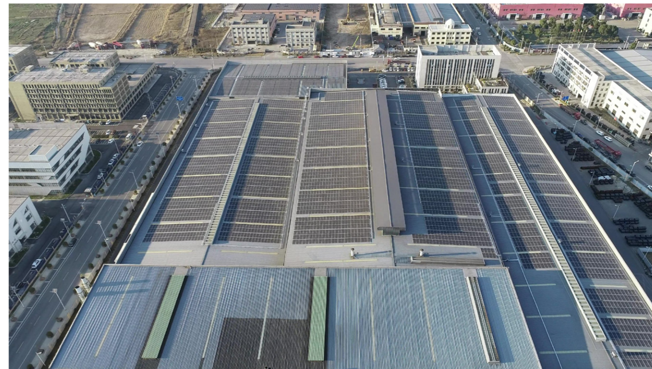
屋顶光伏发电
