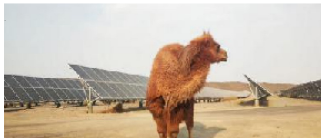
乌海 100MW 光伏项目 供货内容：箱式变压器、支架、逆变升压一体机、组件
