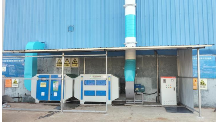
西南铜业危险废物库房 VOCs 治理设施
