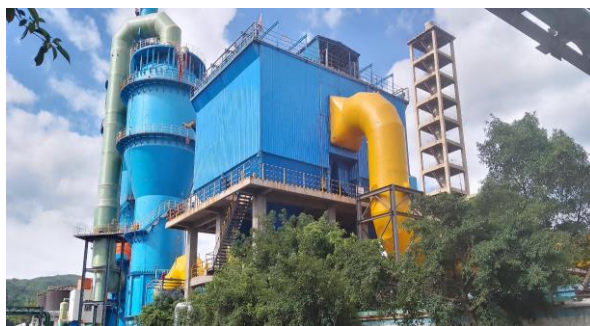
滇中有色新建环集脱硫设施
