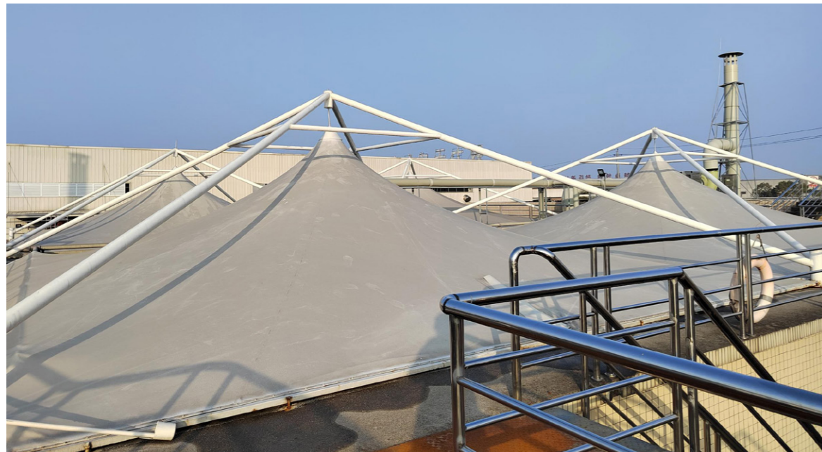
污水处理站—厌氧工艺
