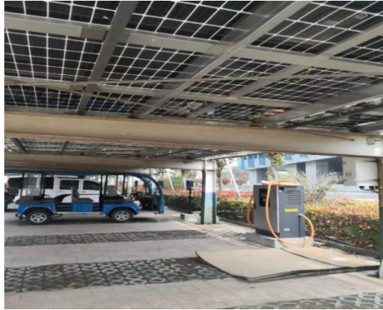
车棚光伏电站
