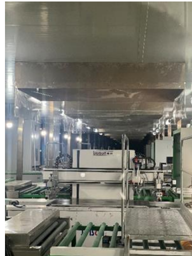
车间废气收集集气罩改造
