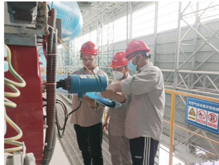
绵阳中科工程师在巡检
