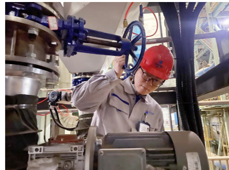
锅炉专工在现场查看新设备
