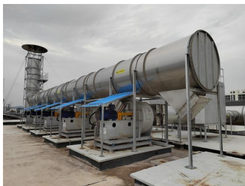
惠州华星挥发性有机废气活性炭吸附塔
