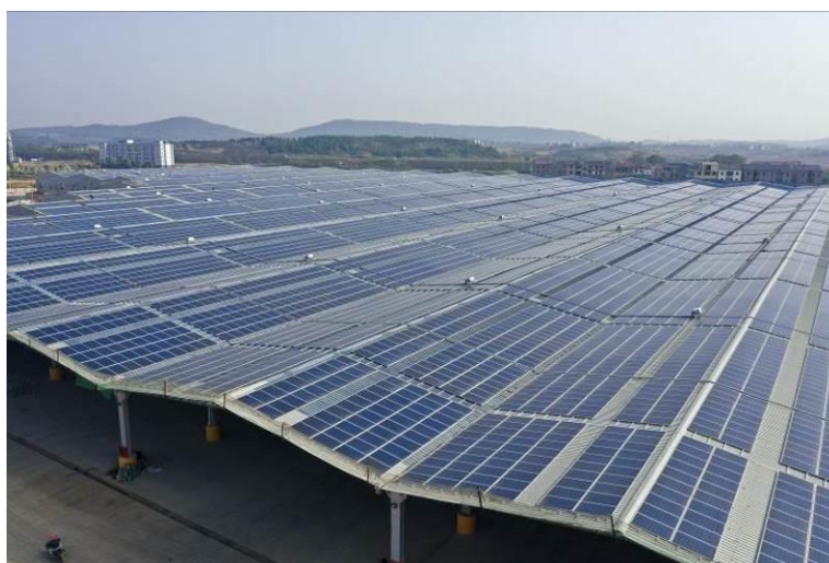
发行人江西丰城生产基地光伏厂房
