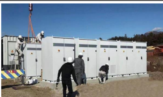
日本群马 2.15MWh 储能电站
