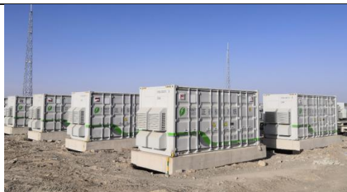
甘肃阿克塞、高台 160MWh 储能电站
