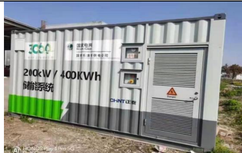
浙江温州 10MWh 储能电站
