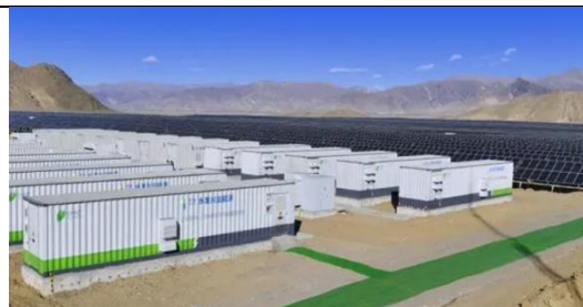
西藏日喀则 100MWh 储能电站
