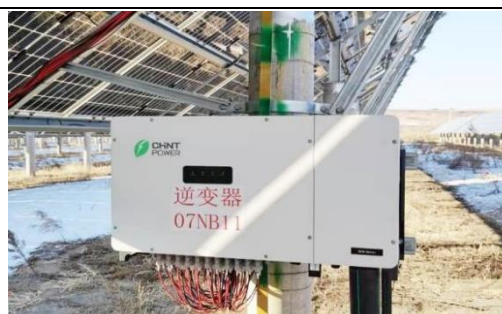
阜新 70MW 光伏发电电站
