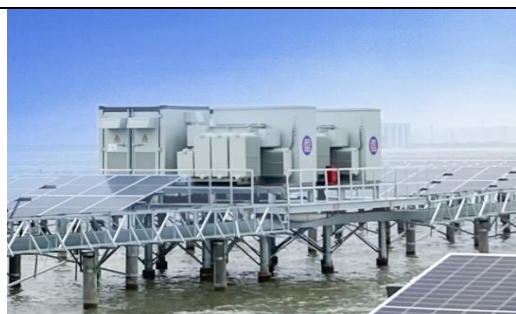
温州泰瀚 550MW 渔光互补电站
