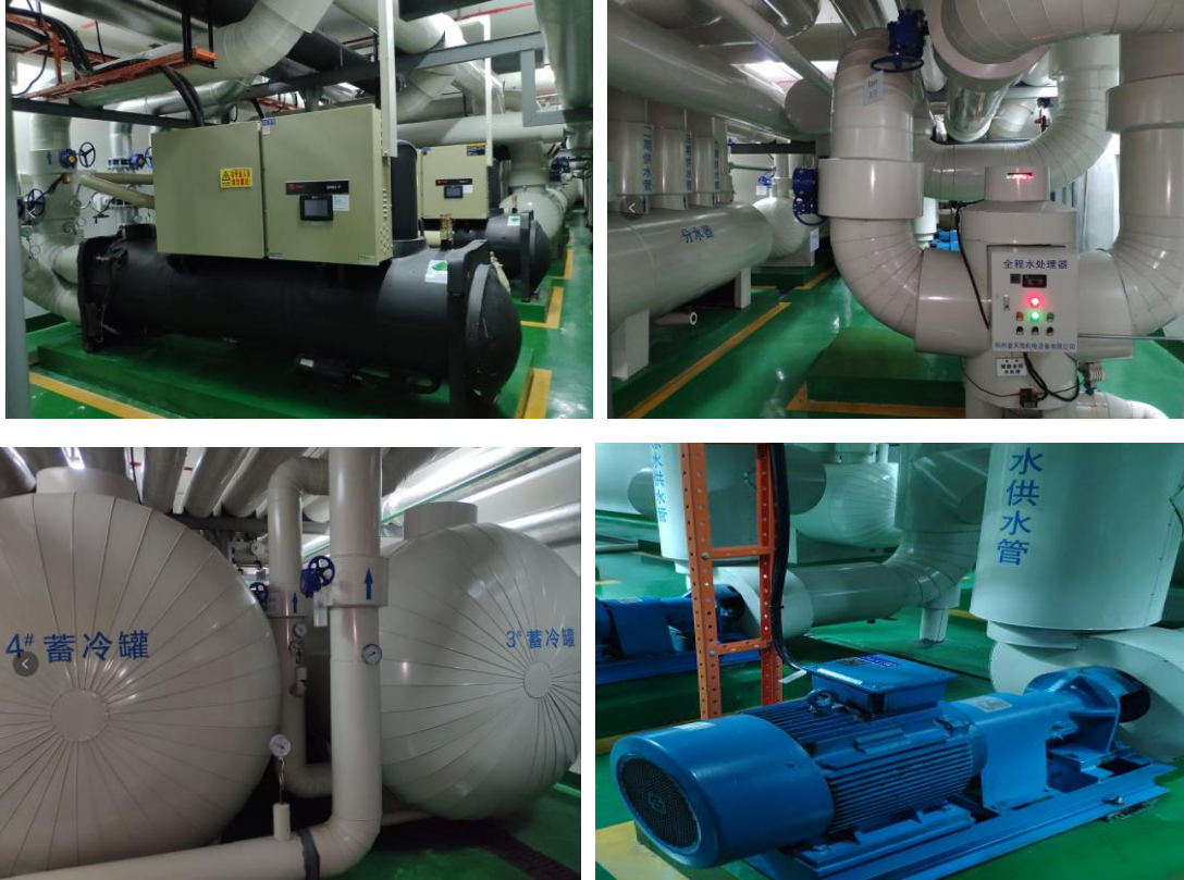
数据处理中心机房高效节能系统
