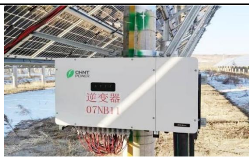
阜新 70MW 光伏发电电站
