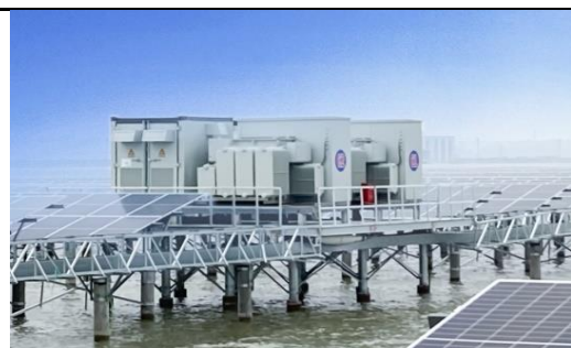
温州泰瀚 550MW 渔光互补电站
