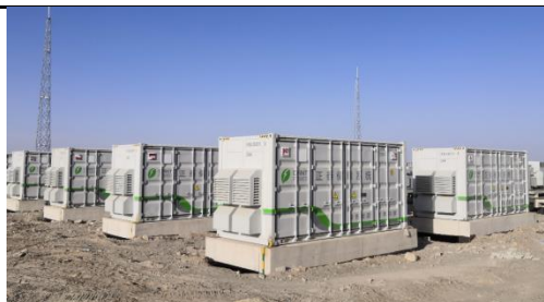
甘肃阿克塞、高台 160MWh 储能电站
