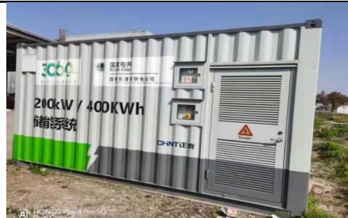
浙江温州 10MWh 储能电站
