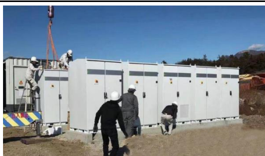
日本群马 2.15MWh 储能电站
