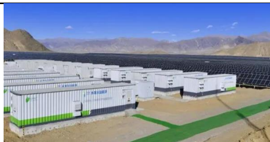
西藏日喀则 100MWh 储能电站
