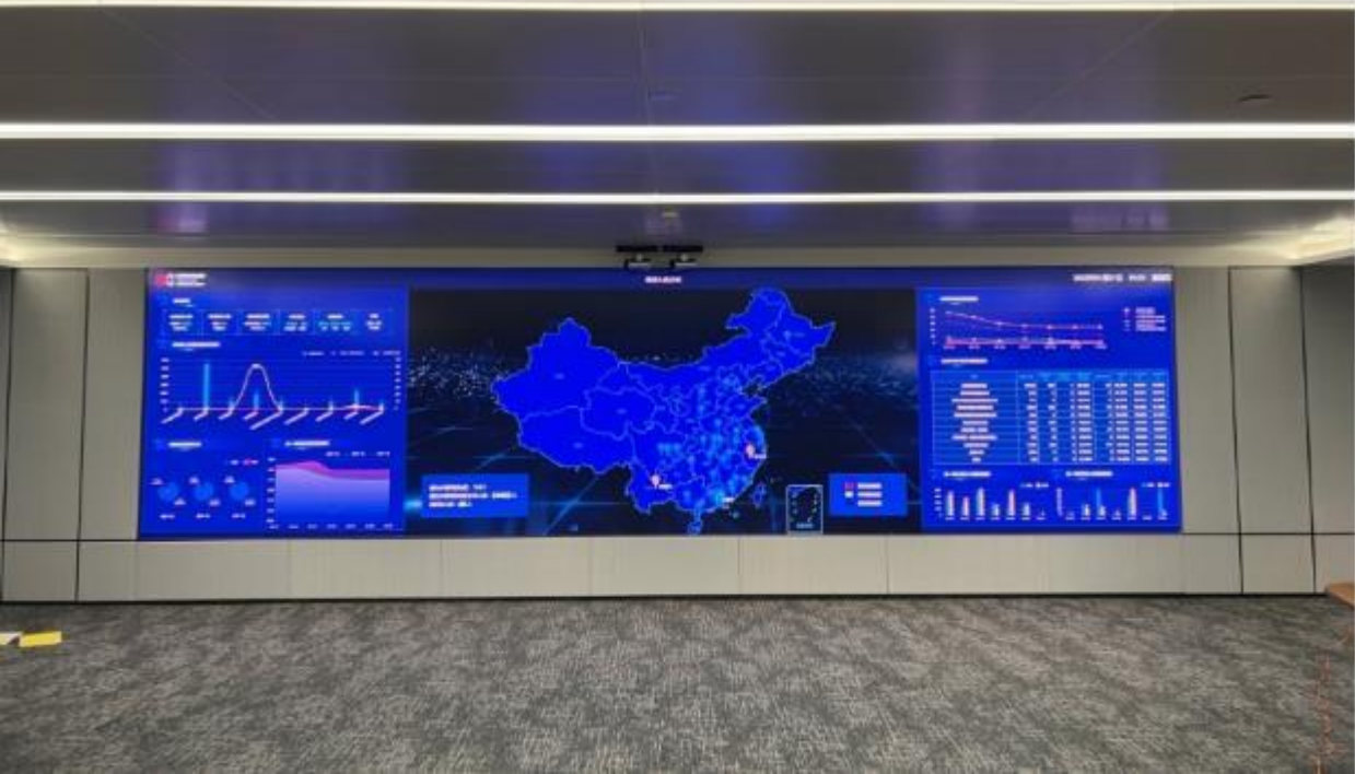
深圳机场应急监测中心系统 COB 屏幕
