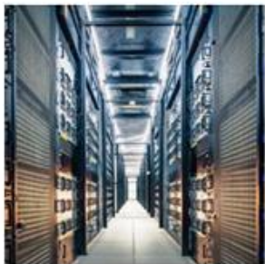
ICT/数据中心
