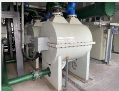
电化学循环水处理装置
