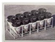
风冷系统+氟泵
