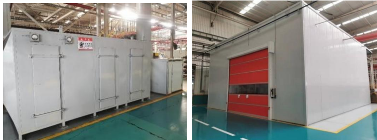
图：桥壳防锈工序废气收集装置
