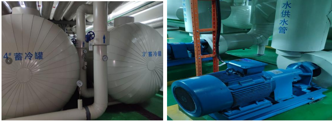
数据处理中心机房高效节能系统
