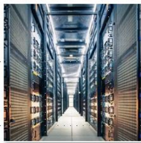
ICT/数据中心
