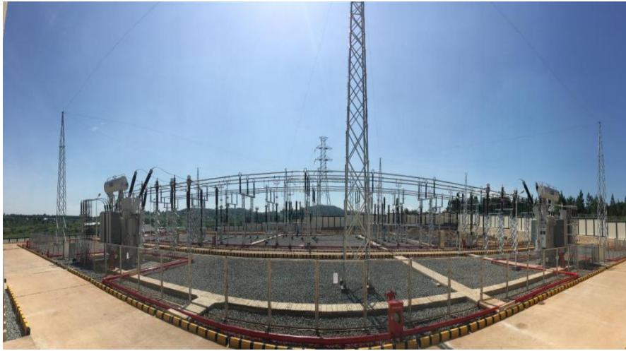
盖塔变电站全景
