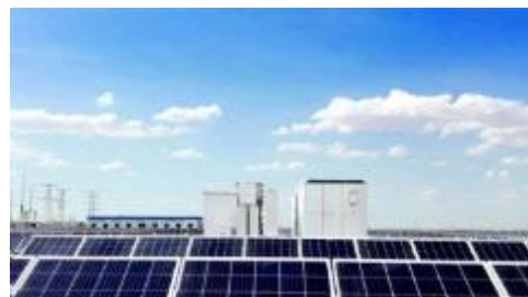
新能源电源管控设备
