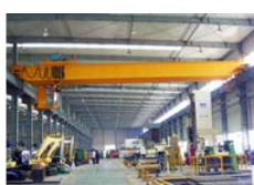
吊钩挂架式起重机应用
