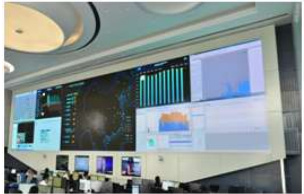
中国民用航空局运行监控中心
