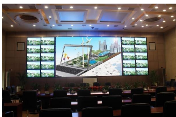
远程监控应用——长沙智慧城市
