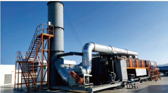
公司废气处理系统
